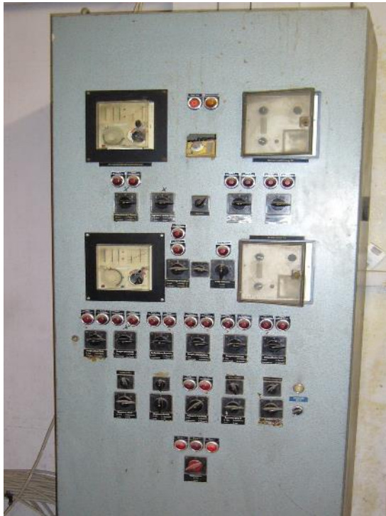
MSR- Schaltschrank veraltete analoge Technik
